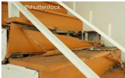
Escalier fortement fragilisé par des termites
